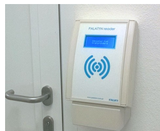
Lecteurs de contrôle d'accès
