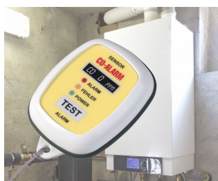
Appareil d'alarme de gaz CO
