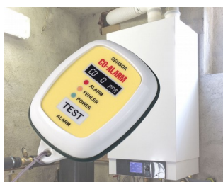
Appareil d'alarme de gaz CO
