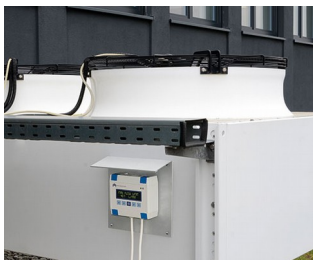
Commande de chauffage/climatisation/ventilation
